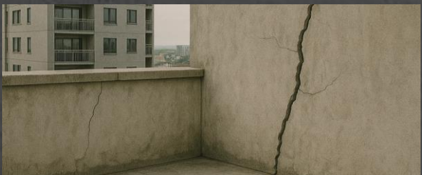
日曬風吹，建築逐漸老化劣化
