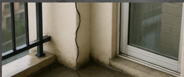
建材無法承受建築荷重，受力不均出現裂痕
