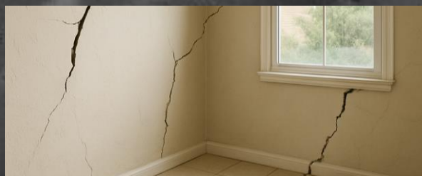
地震頻繁導致結構產生裂縫
